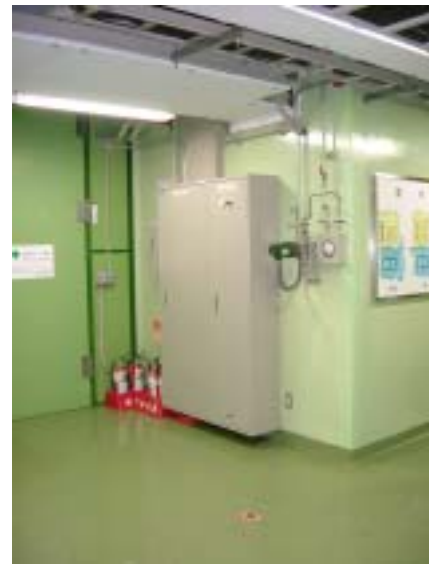
よくない消火器表示の例 (手前の設備の陰になっていて正面以外から見えない)
