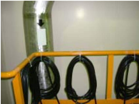
STACY 上部( 実験によって配線が変わるため仮止めされたコード類 ) 作業安全面ではしっかりした固定法の方が望ましいのでは？
