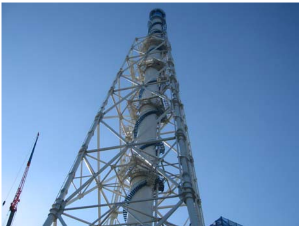
排気筒の上部を軽くし耐震性を強化
