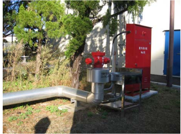
中越沖地震時の教訓から 消火用水配管は地上化
