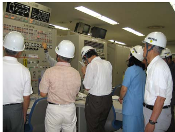
電源制御室 実験はすべてコンピューターで管理
