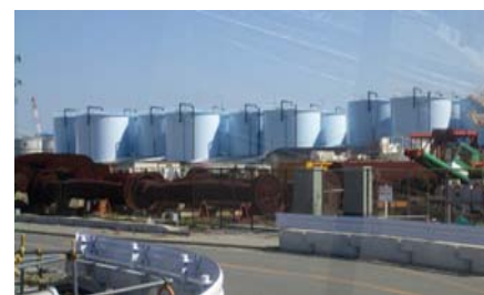
汚染水用タンク群(一部) 東京電力より提供
